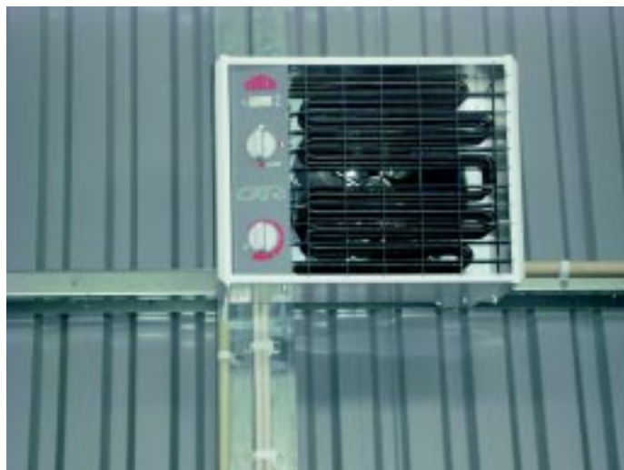
Denna förser lokalen i bästa fall med värme
